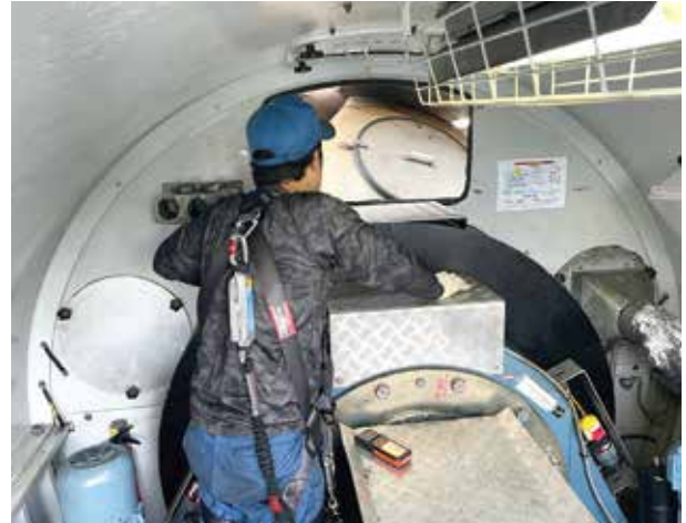
点検後の試運転実施中
